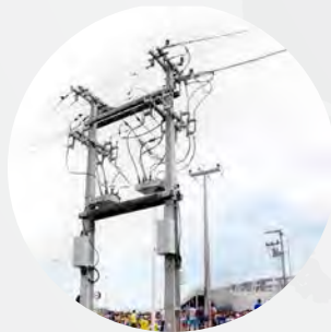
АВТОМАТИЧЕСКИЕ ПУНКТЫ СЕКЦИОНИРОВАНИЯ
