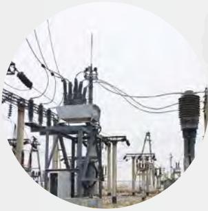
ПЕРЕДВИЖНОЕ ОБОРУДОВАНИЕ ДЛЯ ВОССТАНОВЛЕНИЯ ПИТАНИЯ В АВАРИЙНЫХ СИТУАЦИЯХ
